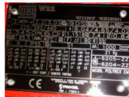
Placa de identificação do motor
